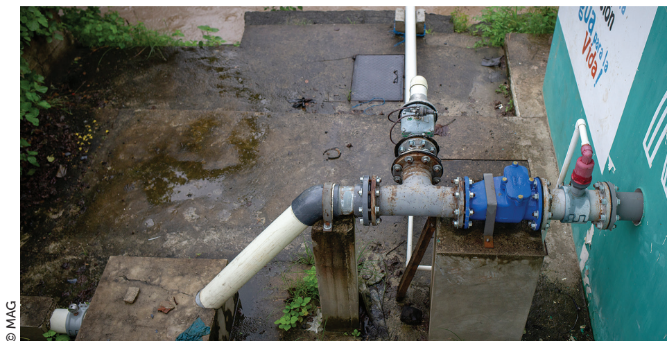
Portoviejo – Manabí. Partes de las instalaciones del sistema de riego tecnificado, las tuberías y las llaves de paso.
