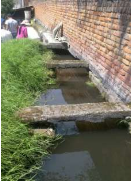
Figura 41. Acumulación del agua después de la sección 3.
