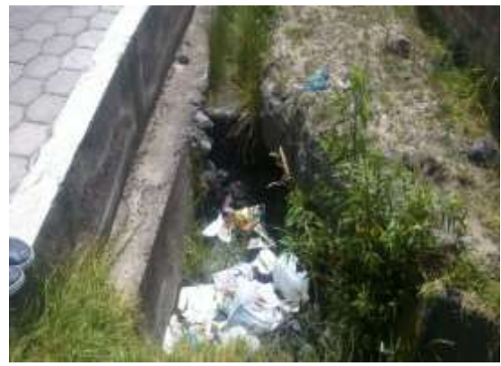
Figura 11. Acumulación de basura en sección revestida.
