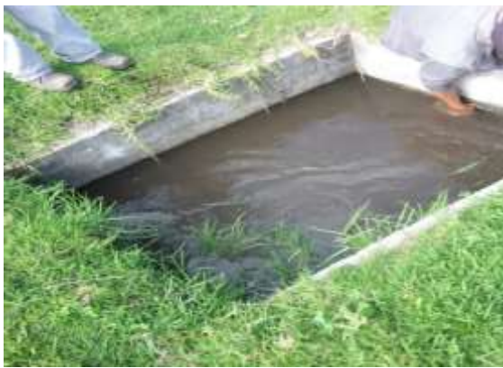
Figura 10. Caja de revisión sin mantenimiento.
