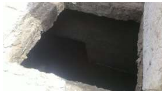
Figura 44. Caja de revisión de la tubería.
