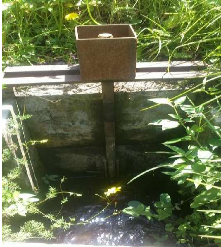
Figura 23. Compuerta de entrada del ramal.
