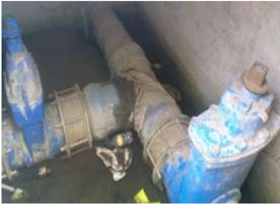
Figura 8. Infraestructura inadecuada en La Cocha.
