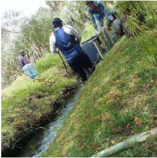
Fotografía 29. Ubicación del canal de Parshall en el punto 2.
