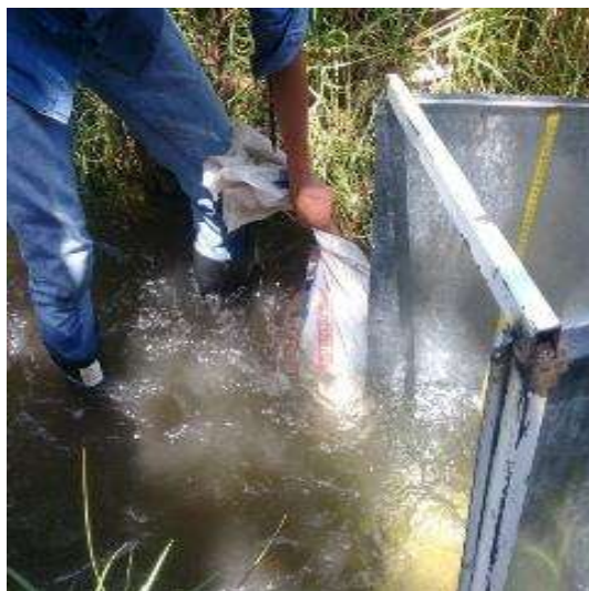
Fotografía 19. Taponamiento de las fugas
