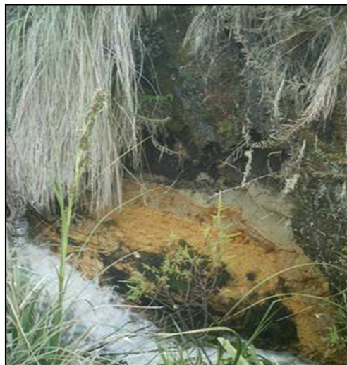
Figura 3.20: Erosión en el fondo del cauce, origina posteriormente caídas de los estratos superiores
