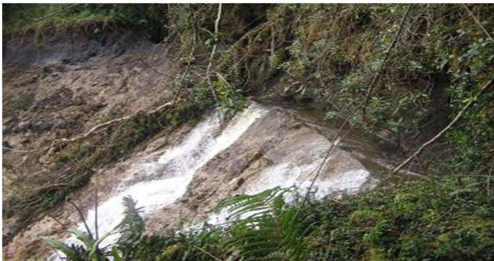
Figura 2.4: Derrumbes y rupturas del canal
