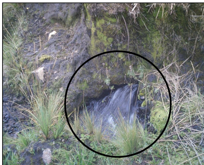
Figura 3.25: Filtración de agua desde el borde del canal en el sector de Los Violines.
