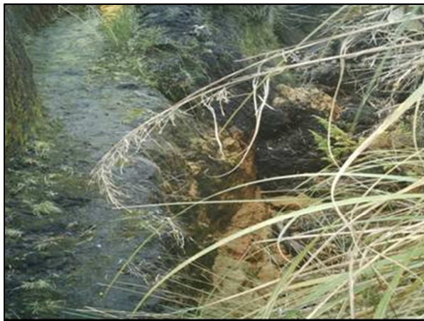
Figura 3.19: El borde del canal se ha deslizado por sobresaturación del suelo
