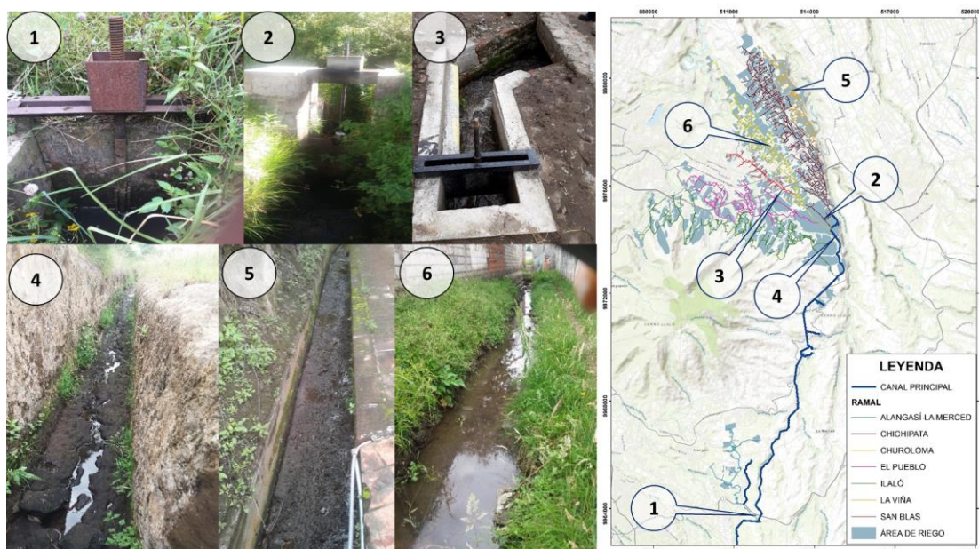
Figura A1.6. Infraestructura de riego: (1) compuerta canal principal – ramal Alangasí, (2) compuerta división ramal Chichipata – ramal Churolooma, (3) toma de entrega a una unidad terciaria, (4) canal principal Tumbaco, (5) canal secundario ramal La Viña y (6) canal terciario ramal Chichipata.
