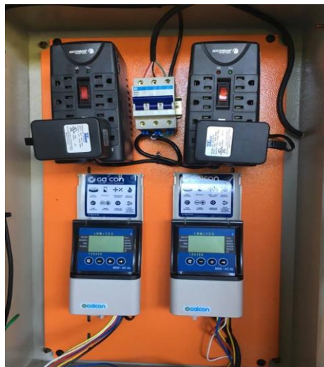
Fotografía 3: Controladores de riego
