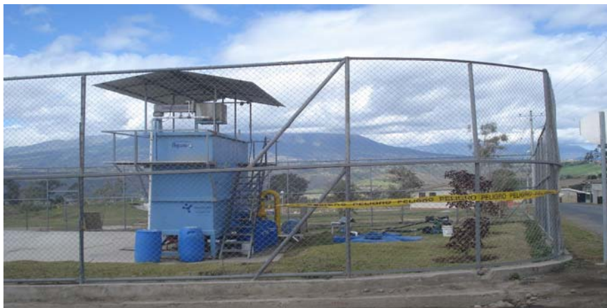
Fotografía No. 4: Moderna Planta de tratamiento de agua potable de paquete instalada para Yachay
