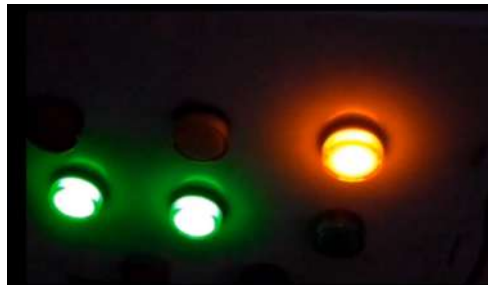
Figura17. Luces piloto encendidas
