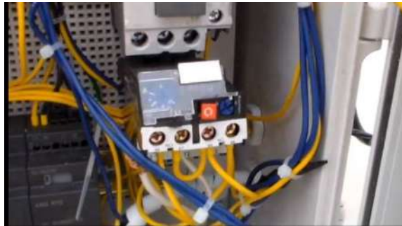
Figura15. Relé térmico de la Bomba
