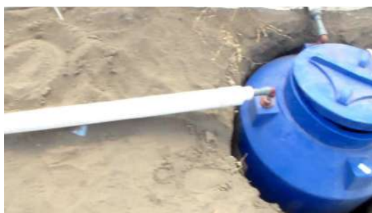
Figura III.21. Tubería de drenaje entrada al tanque 26
