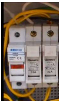
Figura15. Fusibles tablero de control
