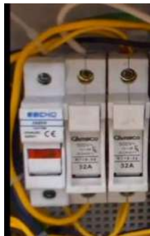
Figura IV.32. Fusibles tablero de control 40
