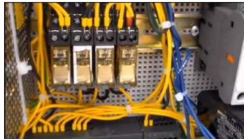
Figura IV.35. Relés de estado sólido 44
