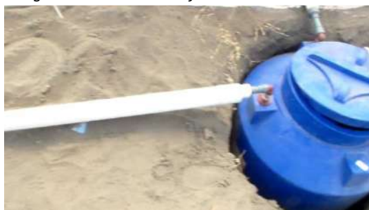
Figura7. Tubería de drenaje entrada al tanque
