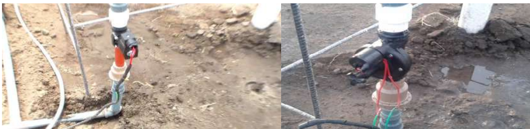
Figura IV.26. Electroválvula del sistema1 y sistema 2 33
