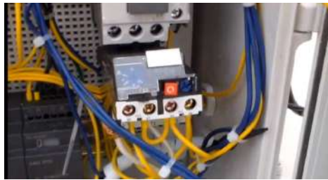
Figura IV.36. Relé térmico de la Bomba 45
