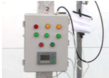
Figura IV.45. Tablero de control del Prototipo 55
