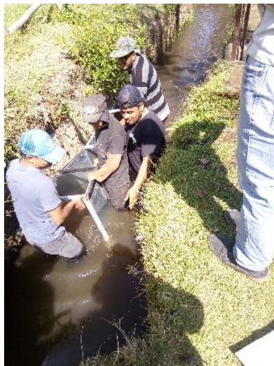
Fotografía 30.- Taponamiento de las fugas
