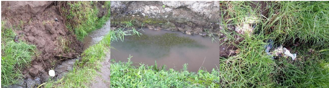
Fotografía 7.- derrumbe y con material flotante
