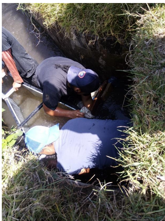
Fotografía 31.- Taponamiento de las fugas
