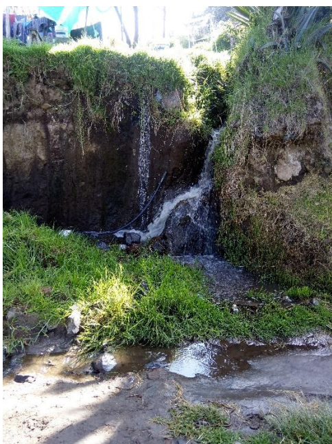
Fotografía 21.- Pérdidas por fugas
