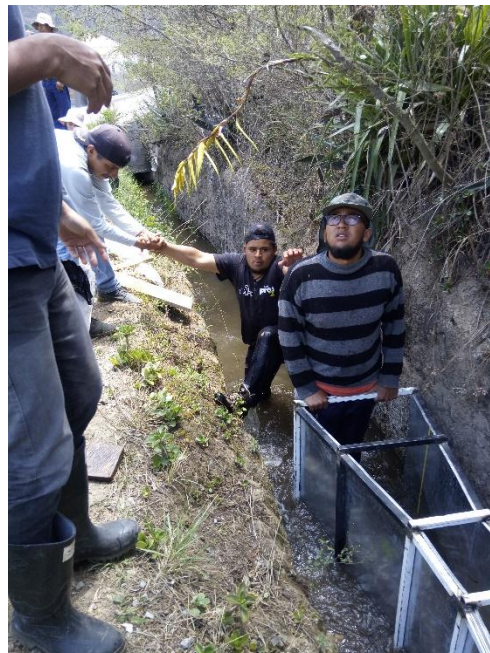
Fotografía 43.- sacado del Parshall del canal
