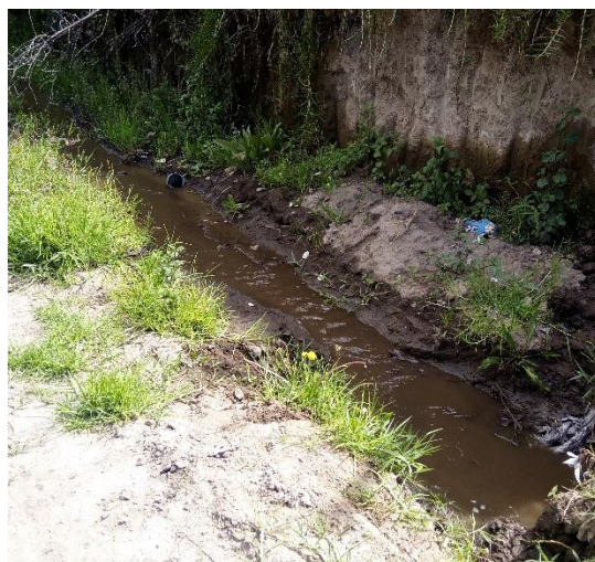
Fotografía 24.- Perdidas por infiltración
