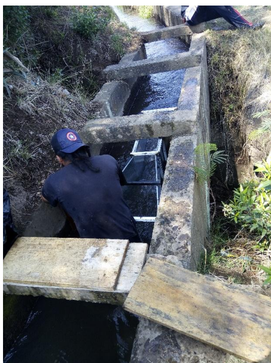
Fotografía 35.- Sellado de las fugas
