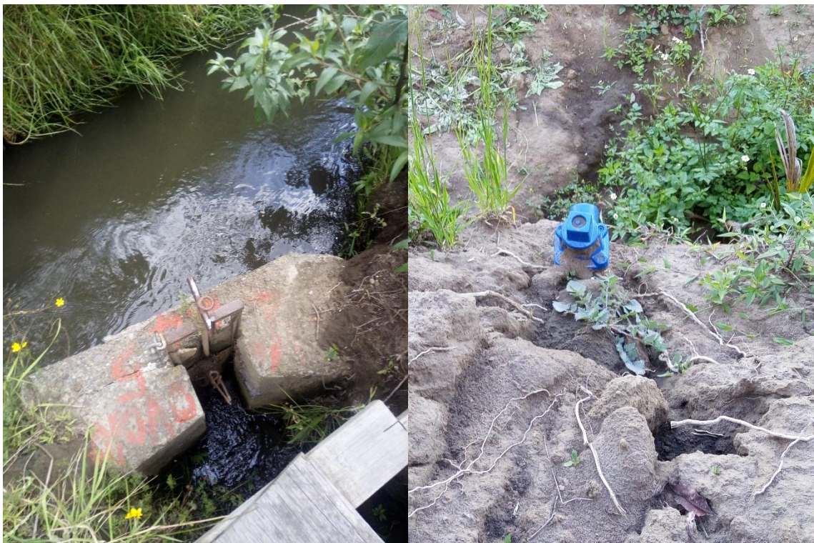
Fotografía 10.- compuerta de entrada del óvalo 5-7
