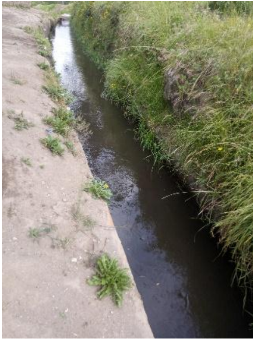
Fotografía 44.- canal secundario que abastece al óvalo 5-7
