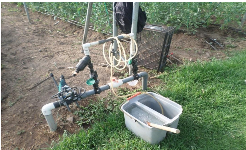
Figura 34. Ventury conectado al sistema de riego.
