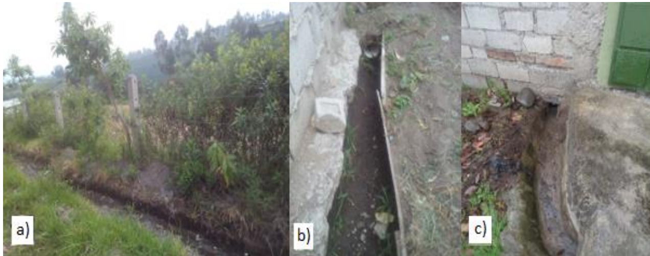
Anexo 4: Respaldo fotográfico de la infraestructura de acometidas. a) Tipo tierra. b) Entubada. c) Revestida
