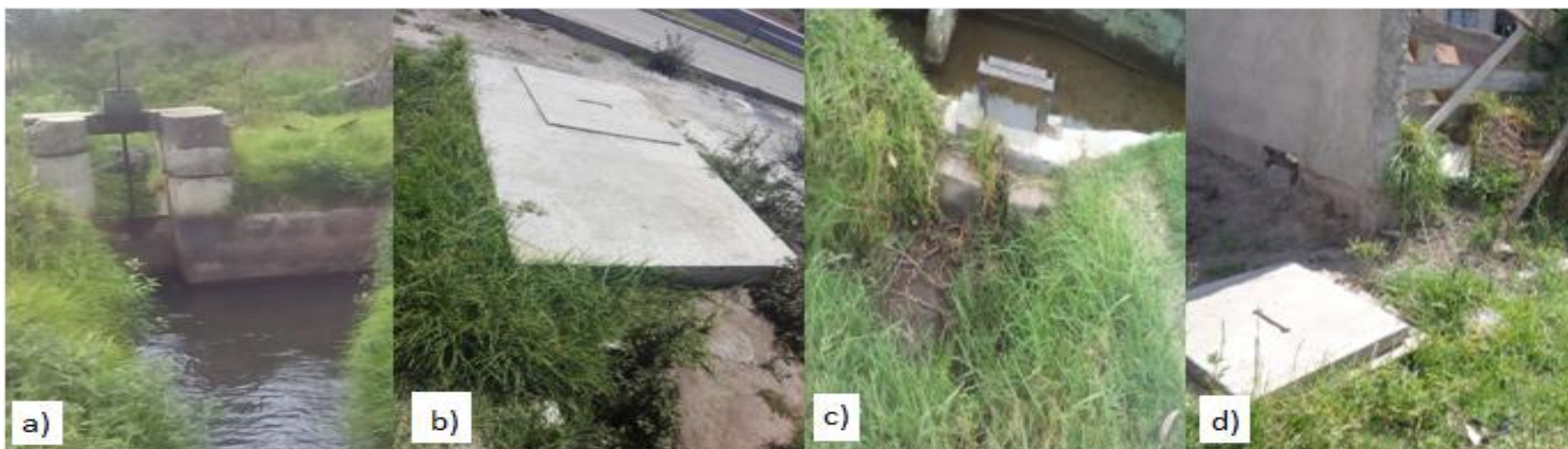
Anexo 5: Registro fotográfico de los elementos de la infraestructura del canal de riego del Ramal Chichipata, zona 1. a) Repartidor. b) Sifón. c) Óvalo. d) Caja de revisión.
