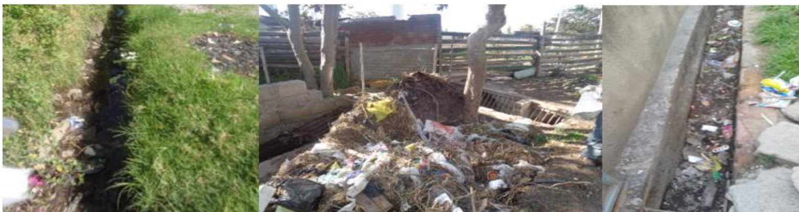
Anexo 6: Evidencia fotográfica del mal mantenimiento del canal de riego del Ramal Chichipata, zona 1.
