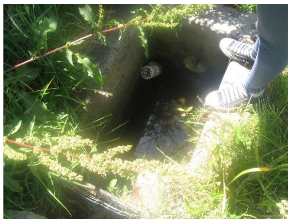
Toma de punto de acometida
