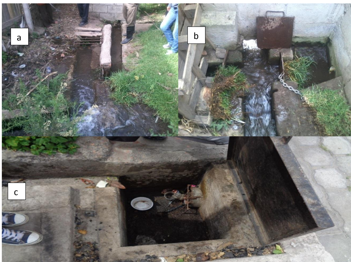
Figura 13. Principales problemas hallados en el Canal de riego. a) Canal del Ramal Chichipata, zona 3, taponado por acumulación de basura e infraestructura mal diseñada b) Distribuidor del canal abierto fuera de horario; c) Caja de revisión con acumulación de basura.
