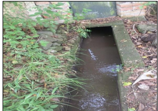
Fotografía 50. Canal revestido, problemas de acceso al mantenimiento.
