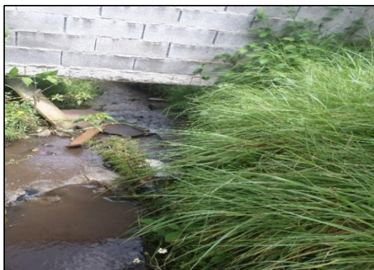
Fotografía 11. Sección obstruida por material de construcción.
