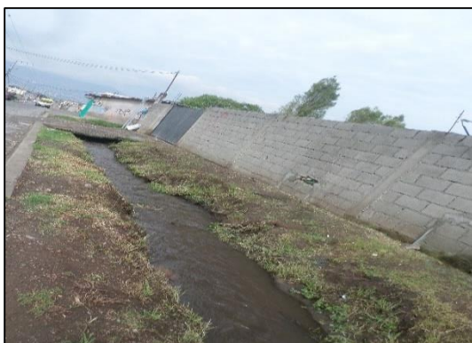
Fotografía 5. Sección irregular no revestida, desbordes. Contaminación por el área fabril.
