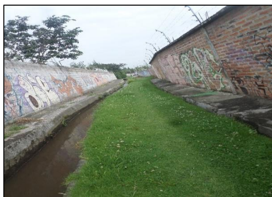
Fotografía 36. Sección revestida, falta de mantenimiento, presencia de sedimentos.
