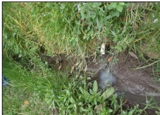
Fotografía 2. Descarga de aguas servidas en el canal.
