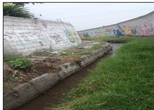
Fotografía 34. Sección revestida, presencia de sedimentos y basura.
