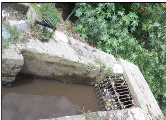
Fotografía 9. Sección revestida, acumulación de basura.
