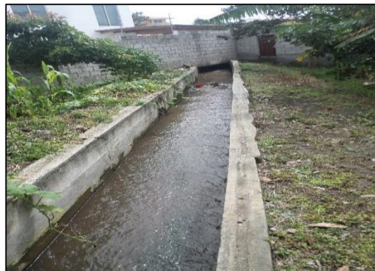
Fotografía 40. Sección revestida, presencia de sedimentos en el interior del canal.
