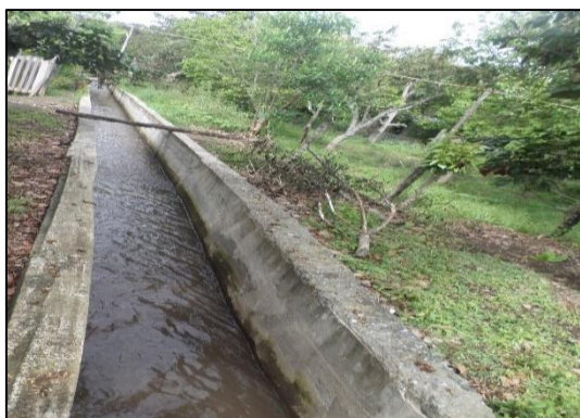
Fotografía 39. Sección revestida, presencia de sedimentos en el interior del canal.
