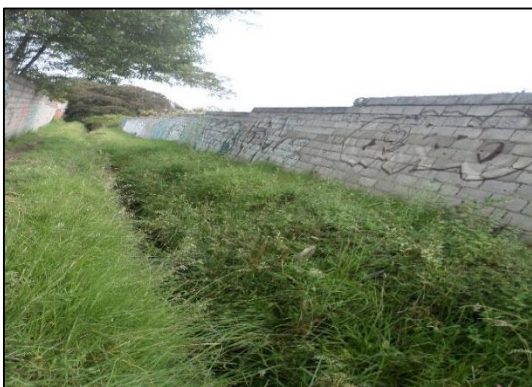
Fotografía 7. Sección completamente obstruida por la vegetación.
