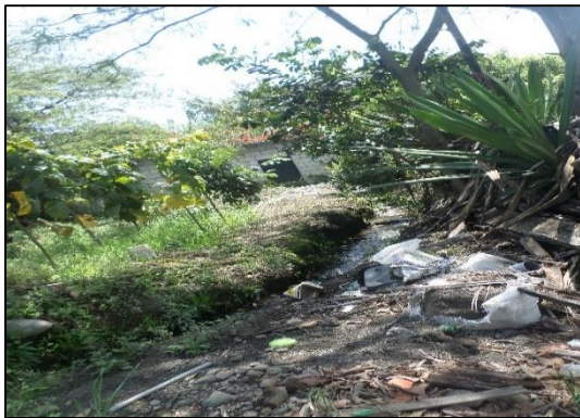
Fotografía 15. Obstrucción por rastros de construcción en el canal.
