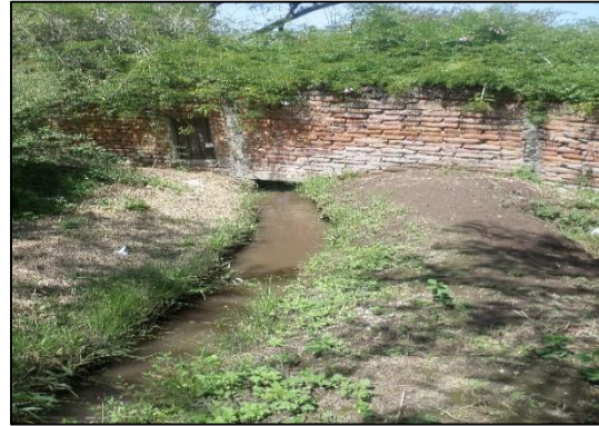
Fotografía 14. Problemas que impiden el mantenimiento. Sección no revestida.
