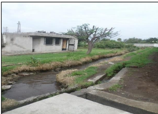
Fotografía 35. Sección no revestida irregular, construcciones y contaminación por basura.
