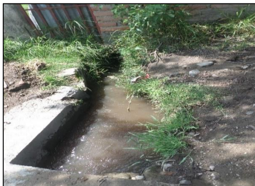
Fotografía 12. Deterioro de la sección, mal mantenimiento del canal.
