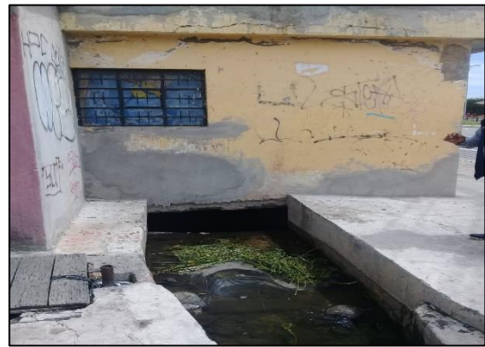
Fotografía 30. Problemas de obstrucción, difícil acceso para el mantenimiento
