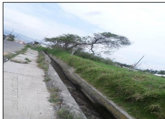
Fotografía 20. Sección revestida, problemas de desbordes en invierno.
