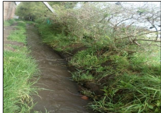
Fotografía 32. Sección no revestida, falta de mantenimiento.
