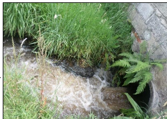
Fotografía 28. Tubería, donde atraviesa el caudal proveniente de la ruta viva.
