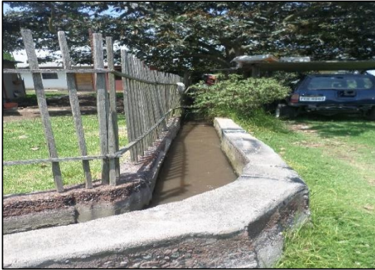
Fotografía 53. Sección revestida, angosta, constantes desbordes en épocas lluviosas.
