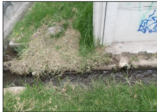
Fotografía 22. Sección revestida. Problemas de desborde.
