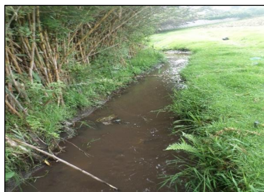
Fotografía 38. Sección no revestida irregular, falta de limpieza, problemas de basura.
