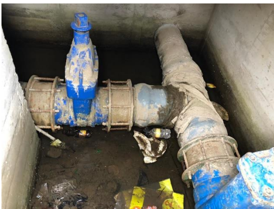
Figura 33. Válvula que conecta a Pacay y La Cocha
