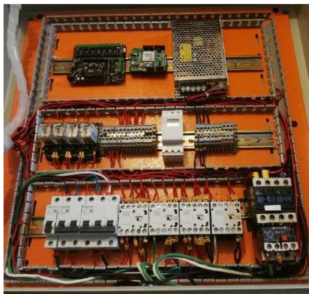
Figura 20-2: Cableado de tablero Realizado por: Kleber Chulde, 2017
