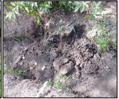
21. Derrumbes cana de tierra
