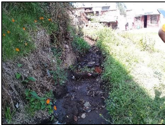
21. Acumulación piedras canal final
