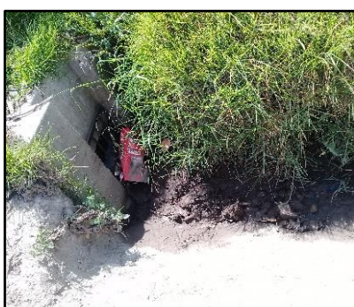
13. Infraestructuras mal estado
